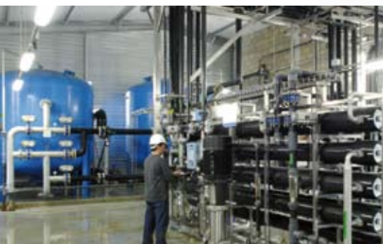
Bio brandstof: filtratie/omgekeerde osmose
